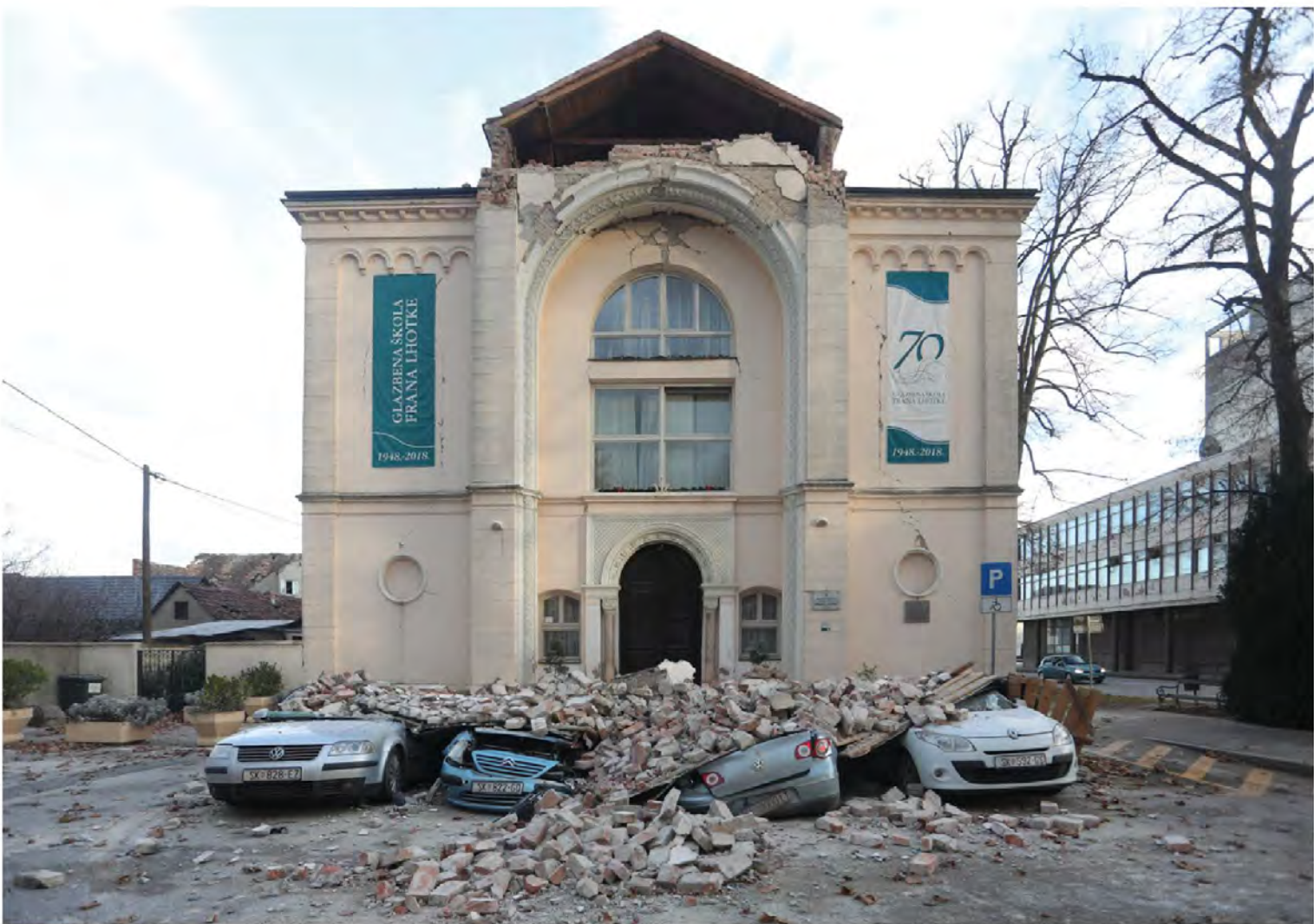
Glasbena šola Frana Lhotke po potresu decembra 2020
