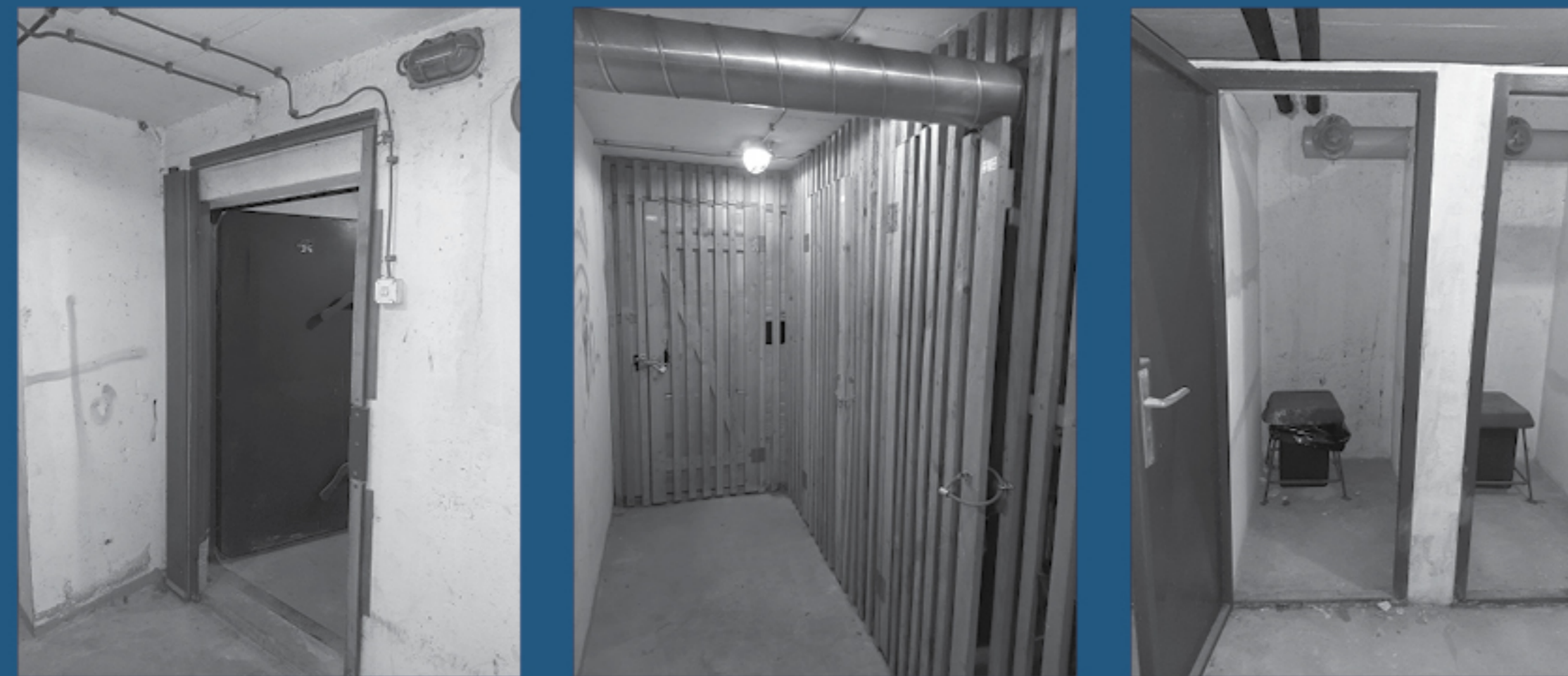
Vhod v zaklonišče Bivalni del zaklonišča - shrambe Suho stranišče
