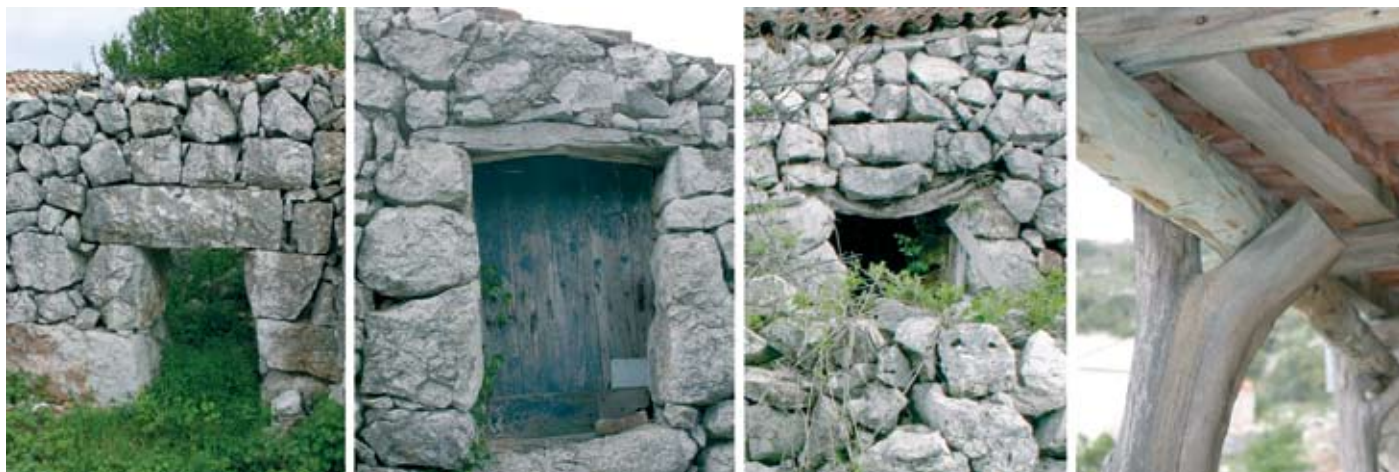
Slika 6: Na območju Kvarnerja in Dalmacije je les dragoceno gradivo. To izpričujejo skromne lesene preklade in smiselna uporaba rogovil pri vertikalnih podpornikih. Nekatere preklade so izvedene napačno bodisi z izbiro nezadostnih presekov bodisi z napačno postavitvijo – razpon z usločeno prekladno. Pravi antipod so predimenzionirane kamnite preklade.
