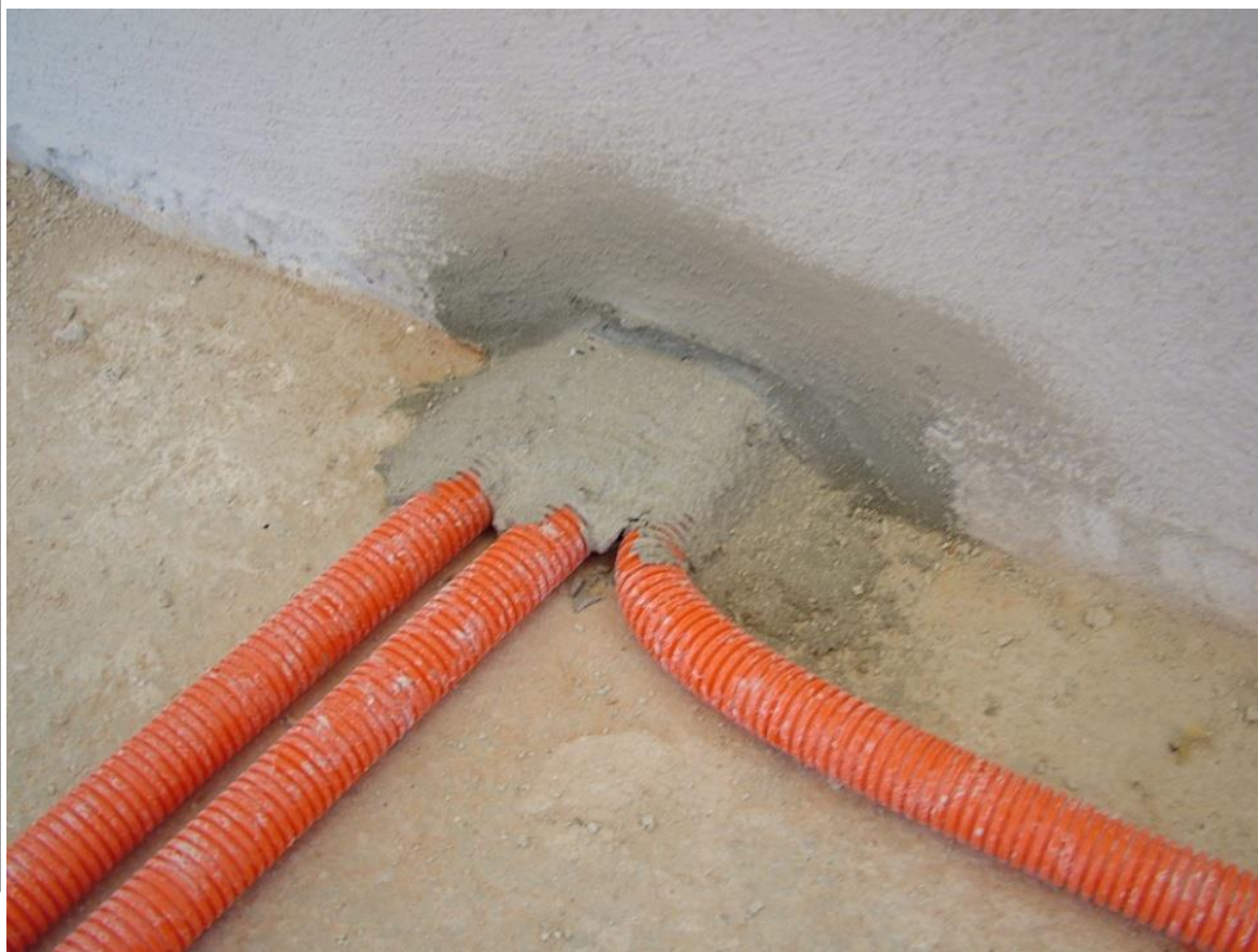
Inštalacije, preboji zidov
