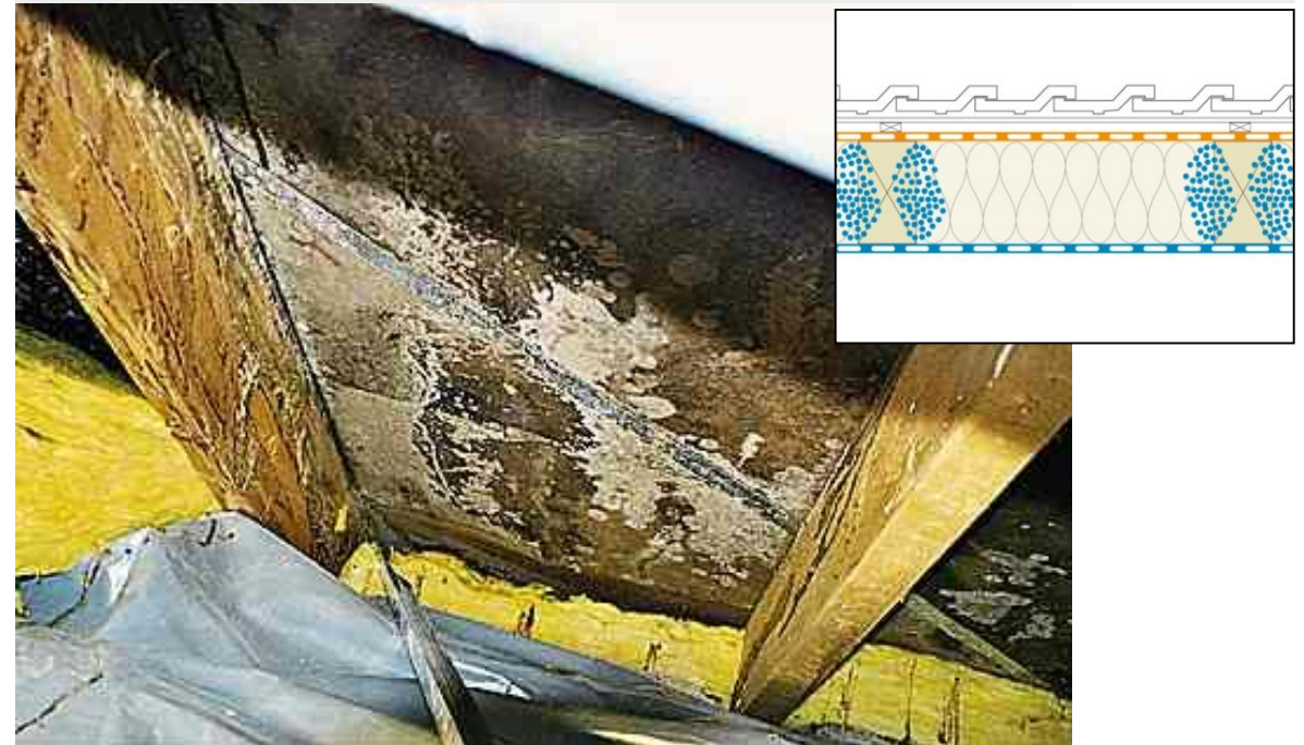
Vlaga v strešni konstrukciji
