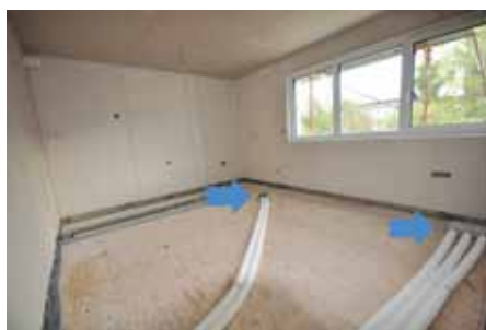
Cevi za prezračevanje spodnjih prostorov potekajo po tleh zgornje etaže (levo dovod zraka v spalnico in desno odvod zraka iz kuhinje, oboje v pritličju).
