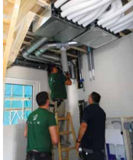
Prezračevalne cevi iz posameznih prostorov so priklopljene na razdelilni kolektor ob prezračevalni napravi. Ta ima vlogo brezšumne razdelitve toka zraka in dušenje zvoka, kar preprečuje prenos zvoka po ceveh med posameznimi prostori. Cevi za prezračevanje so iz PVC. To so rebraste gibke cevi premera 7 cm, v primeru večjega pretoka zraka se vzporedno vgradi več cevi.
