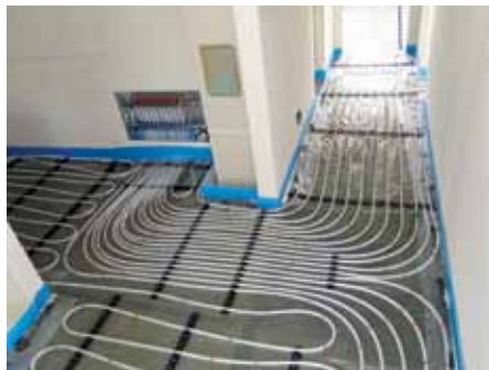
Razvod talnega ogrevanja iz razdelilne omarice v zgornji etaži – cevi so položene na plast zvočne izolacije, zaščitene z ločilnim slojem.
