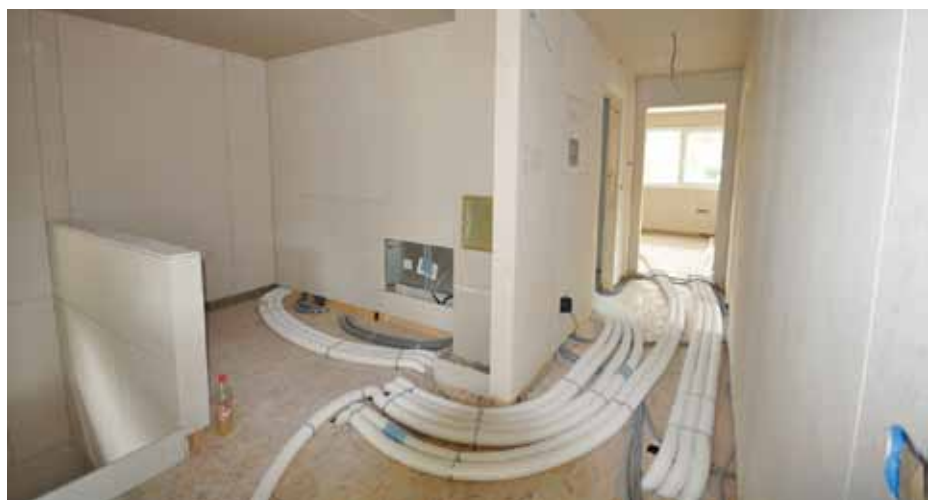
Razvod cevi za prezračevanje poteka po tleh zgornje etaže.
