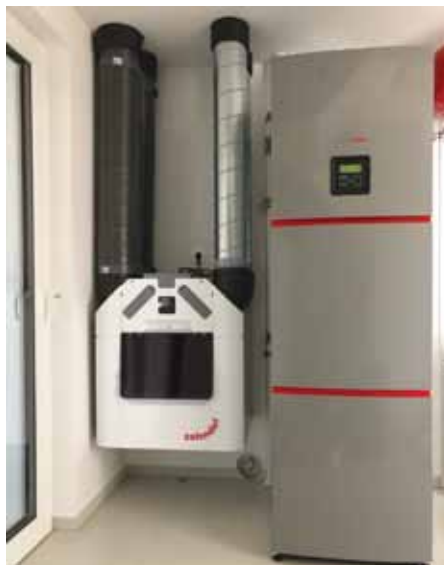
Prezračevalna naprava (levo) in notranji del toplotne črpalke z bojlerjem z zalogovnikom toplote
