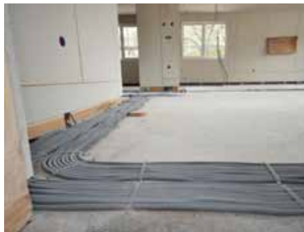
Montaži hiše sledi najprej razvod vodovodnih in električnih instalacij, ki potekajo po plošči
