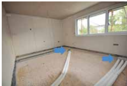
Cevi za prezračevanje spodnjih prostorov potekajo po tleh zgornje etaže (levo dovod zraka v spalnico in desno odvod zraka iz kuhinje, oboje v pritličju).
