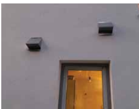
Vstopno ustje za dovod svežega zraka (levo) in izstopno ustje za odvod izrabljenega zraka iz hiše (desno) sta pokrita s pokrovom z mrežico.
