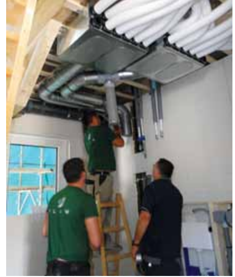
Prezračevalne cevi iz posameznih prostorov so priklopljene na razdelilni kolektor ob prezračevalni napravi. Ta ima vlogo brezšumne razdelitve toka zraka in dušenje zvoka, kar preprečuje prenos zvoka po ceveh med posameznimi prostori. Cevi za prezračevanje so iz PVC. To so rebraste gibke cevi premera 7 cm, v primeru večjega pretoka zraka se vzporedno vgradi več cevi.
