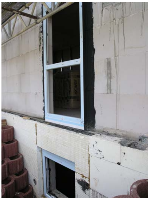
Slika 8: Pravilna vgradnja okna – zgornje okno pred vgraditvijo in spodnje po vgraditvi toplotne izolacije
