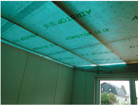
Parna ovira na stropu proti strešni konstrukciji je pritrjena na spodnji del žebeljanih nosilcev
