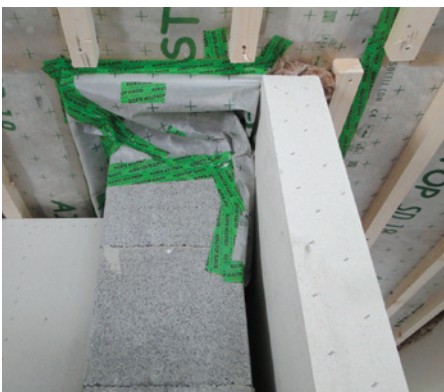
Zrakotesna folija stropne konstrukcije proti podstrešju je prilepljena na dimnik.
