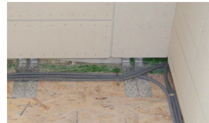
Stik parne ovire v steni nadstropja z zrakotesno folijo, ki prihaja iz spodnje etaže in je zaobjela zunanji rob medetažne konstrukcije.
