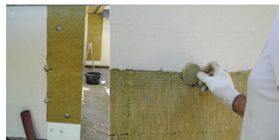
Sidra, s katerimi se pritrdi toplotno izolacijo, so vtpoljena v kameno volno ... in prekrita s toplotno izolacijo, kar preprečuje toplotni most.
