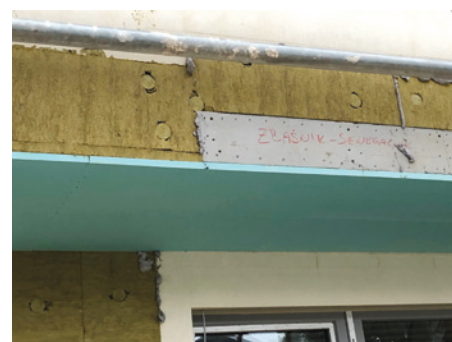
Nosilna konstrukcija previsa fasade se prekrije s toplotno izolacijo, kar zmanjša toplotni most.
