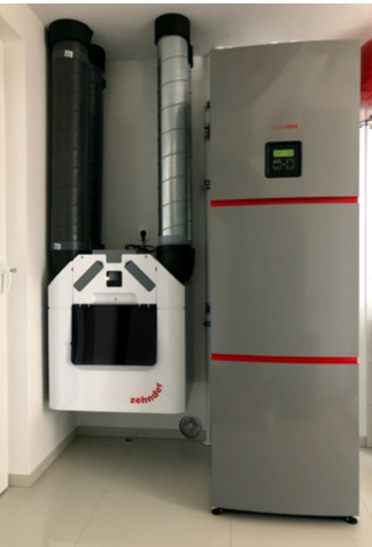
Toploto za talno ogrevanje zagotavlja toplotna črpalka zrak-voda.
