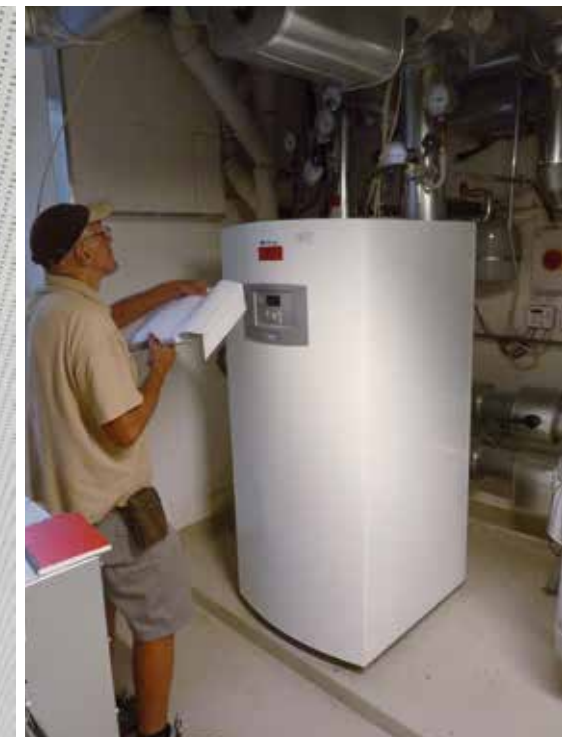
Checking the system parameters
