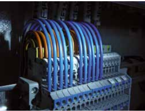
Links: Blick in den Schaltschrank
